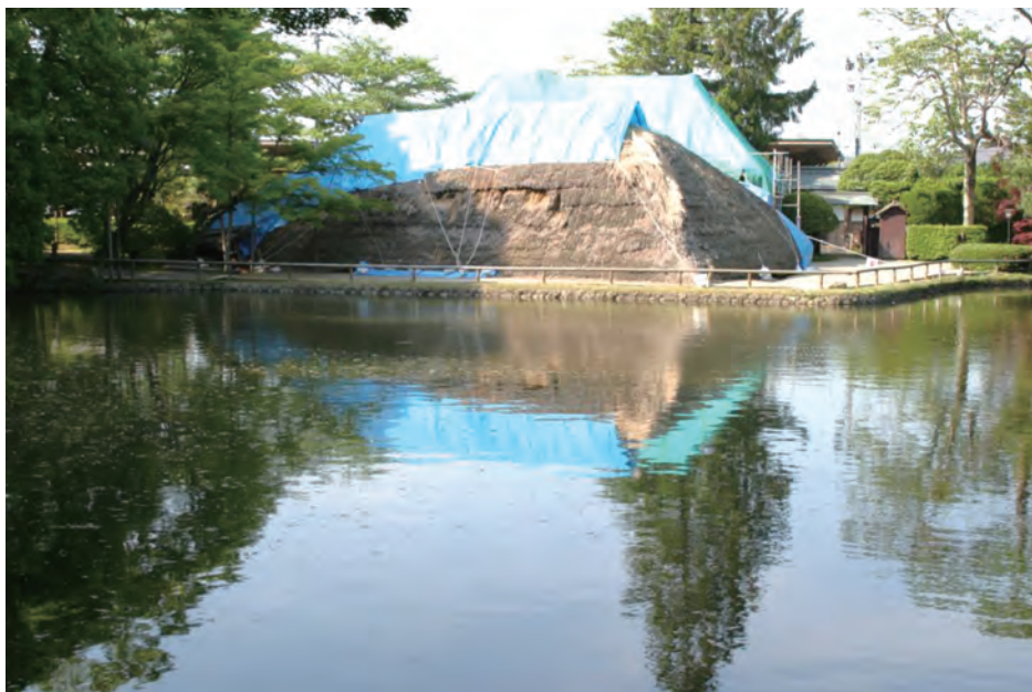
倒壊した旧有備館
