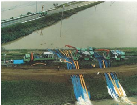
排水ポンプ車（内浦地区）
