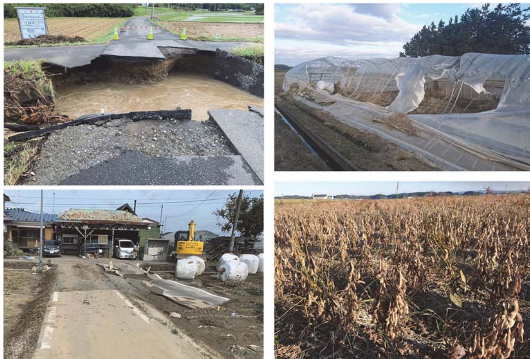
図 3-11 道路・農地被害状況
