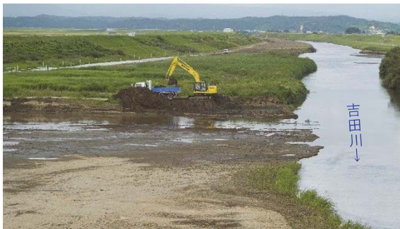
図 3-17 吉田川河道掘削の様子 (品井沼大橋より上流の眺望：R4.9)
