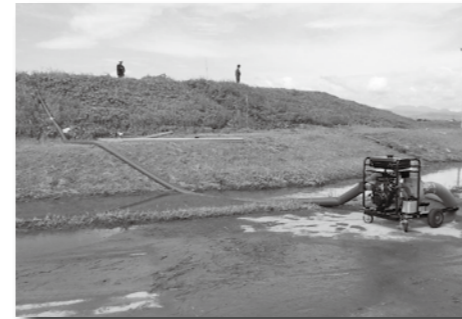
▲緊急排水ポンプの整備(事業③)
