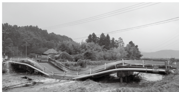
▲令和4年7月15日の大雨による落橋(岩出山地域)
