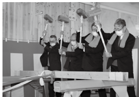
▶四方固め・引綱の儀。無事に工事が完了することを祈願して
