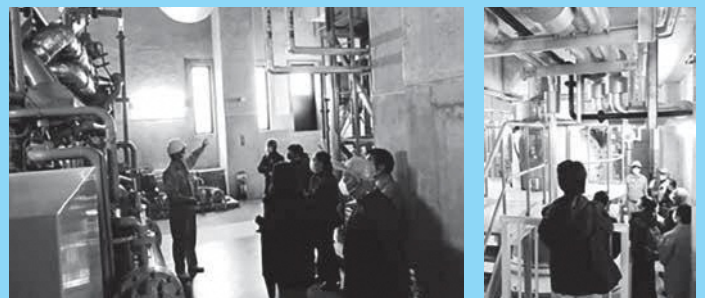
公共下水道施設の運転管理状況を説明している様子です。様々な視点からご意見をいただいています。
