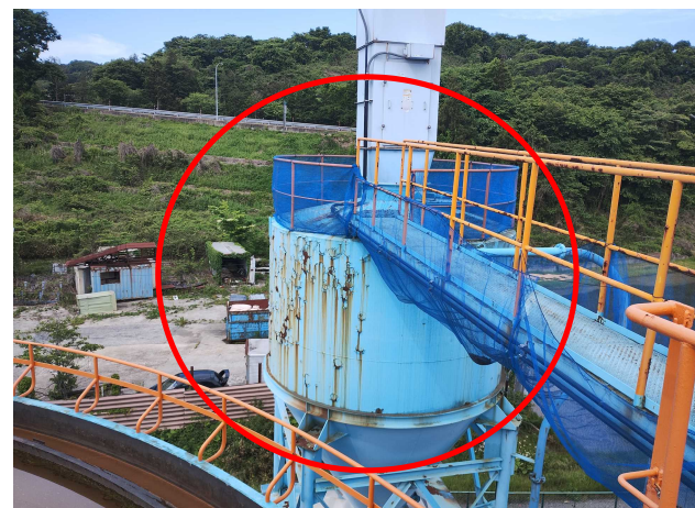
④消石灰タンク
