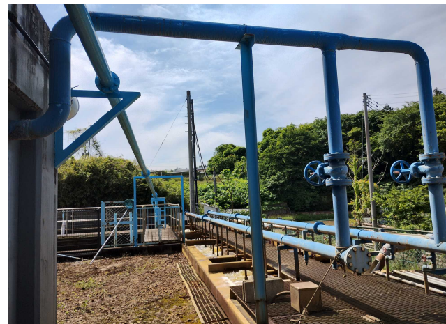
③中和槽配管
