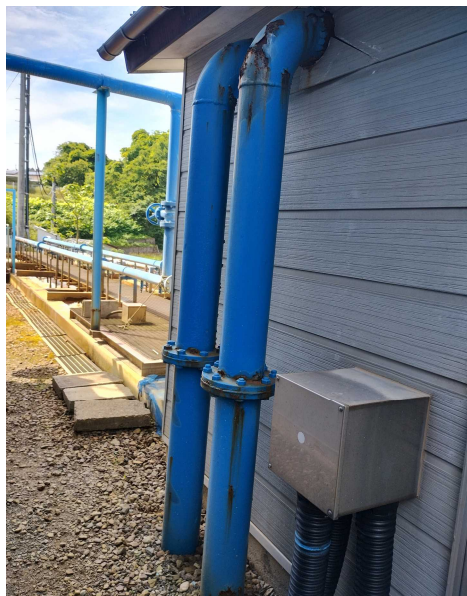
③中和槽配管
