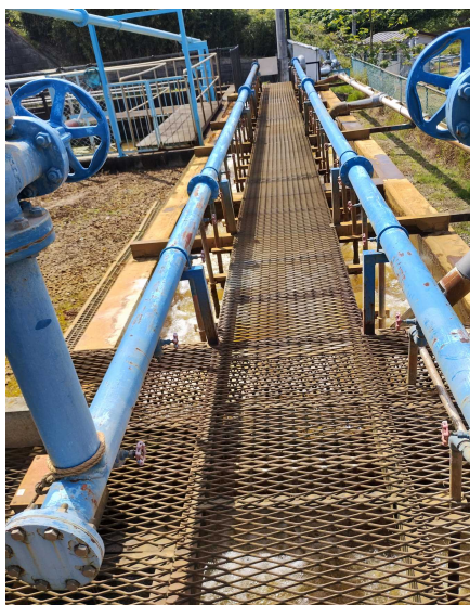
③中和槽配管
