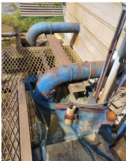
③中和槽配管
