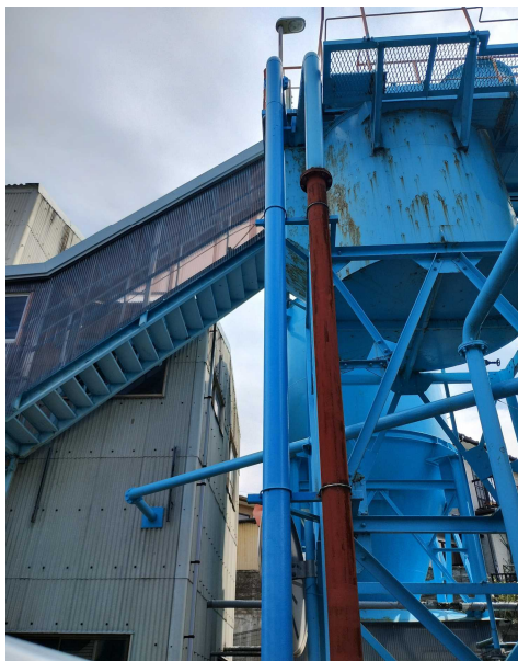
②赤錆色単独配管
