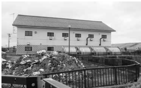
米袋排水機場（古川地域）
