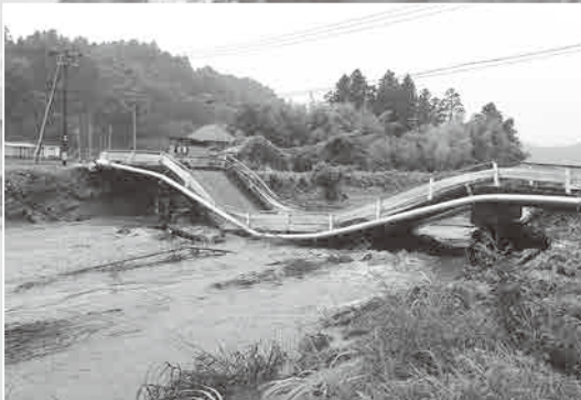
崩落した丸山橋（岩出山地域下野目）
