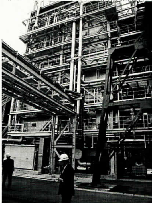
〔住友-フォスターウィラ型循環流動層(CFB)ボイラー全景〕
