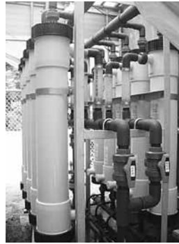
鳴子上原簡易水道仮設ろ過装置
