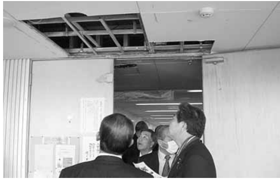
岩出山中学校雨漏り現地調査
