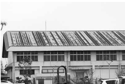
腐食が目立つ古川東中学校体育館
