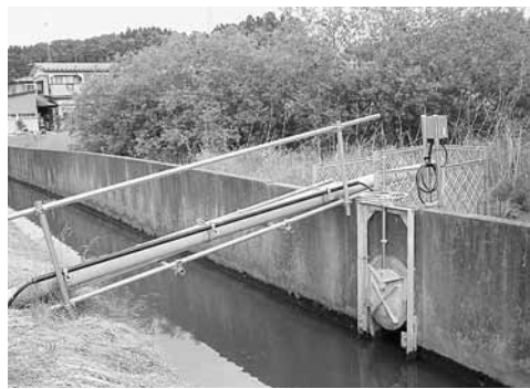
姥ヶ沢排水ポンプ
