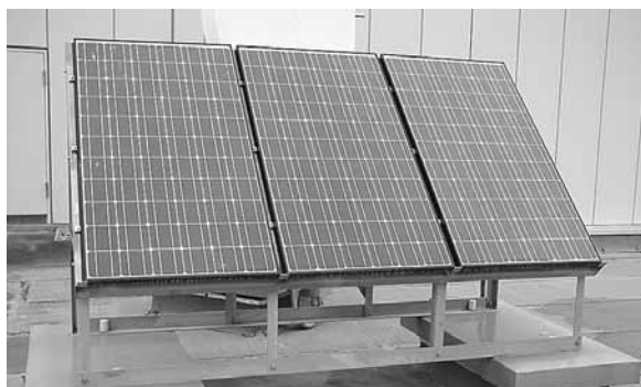
太陽光発電設備（鹿島台総合支所）
