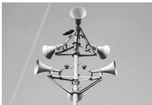
防災行政無線（田尻地域）
