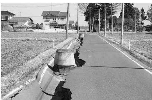
高柳地区マンホール隆起 (三本木)
