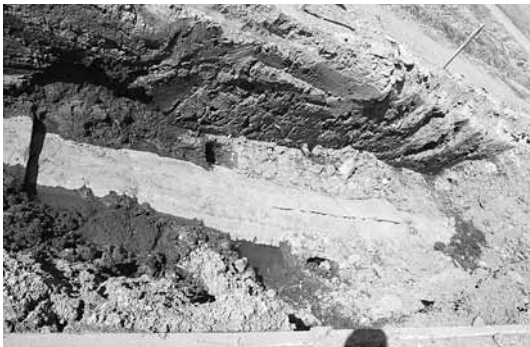
志田谷地区パイプライン 破損(鹿島台)
