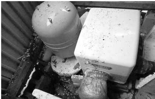
自家用ボーリング井戸水くみ上げポンプ
