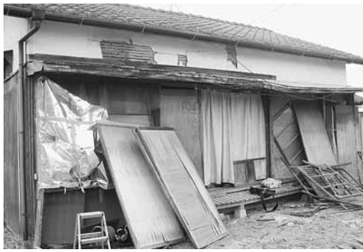
被災した市営住宅
