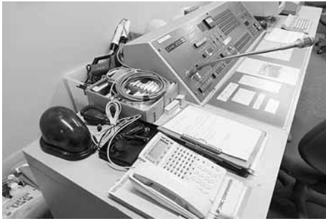
総合支所の防災行政無線操作卓
