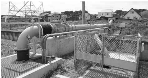
排水ポンプ施設 (鹿島台地域)
