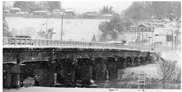
老朽化した川渡大橋（鳴子温泉地域）
