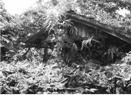
倒壊の可能性がある放置された空き家
