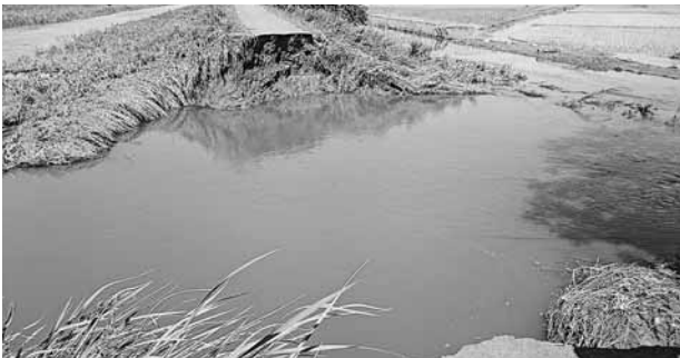
渋井川の堤防破堤状況 (古川地域西荒井地区)
