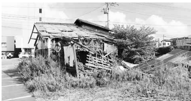
早急な対策が待たれる空き家
