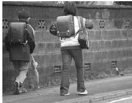
通学路沿いにあるブロック塀
