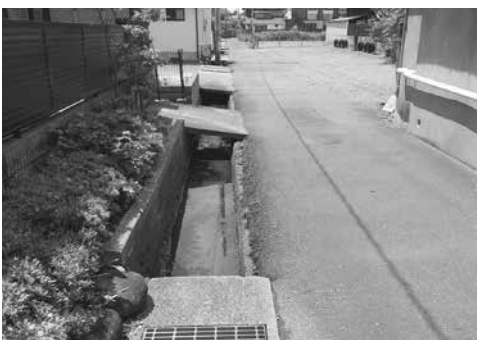
改良工事の要望があった排水路（古川地域）
