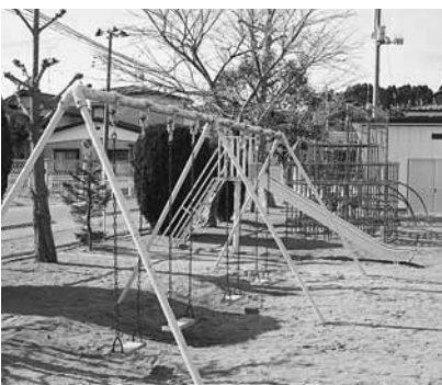
修理を待つ幼稚園遊具(鹿島台第三幼稚園)
